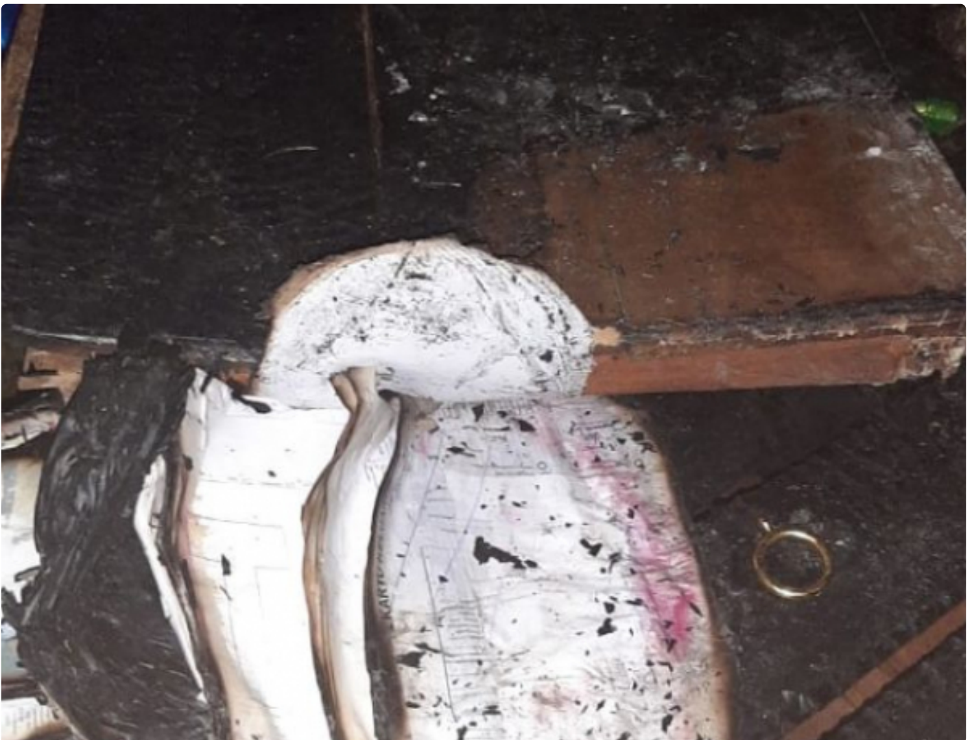
Kondisi terkini Kantor Desa Wolowea pasca kebakaran
